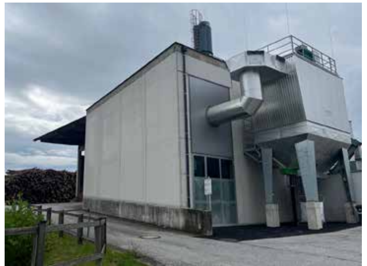
Die Nahwärme mit umweltfreundlicher Wärme | © Nahwärme
