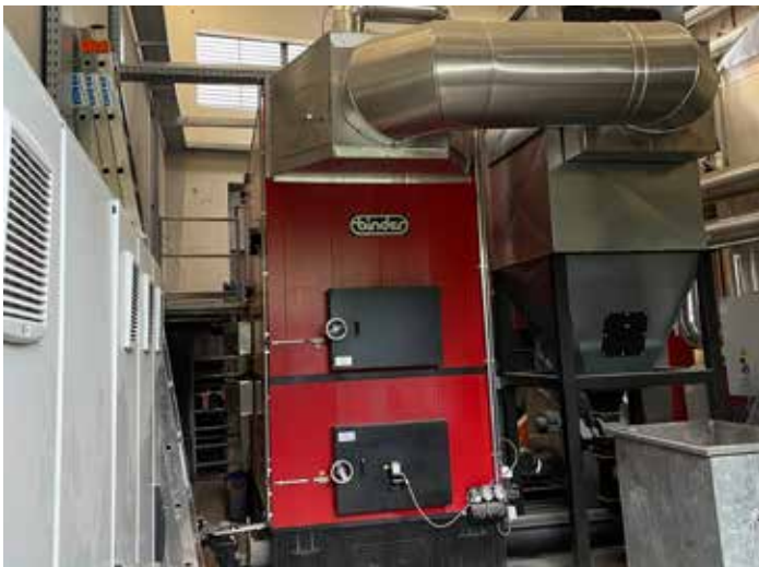
Der neue 1,5 MW Biomassekessel | © Nahwärme
